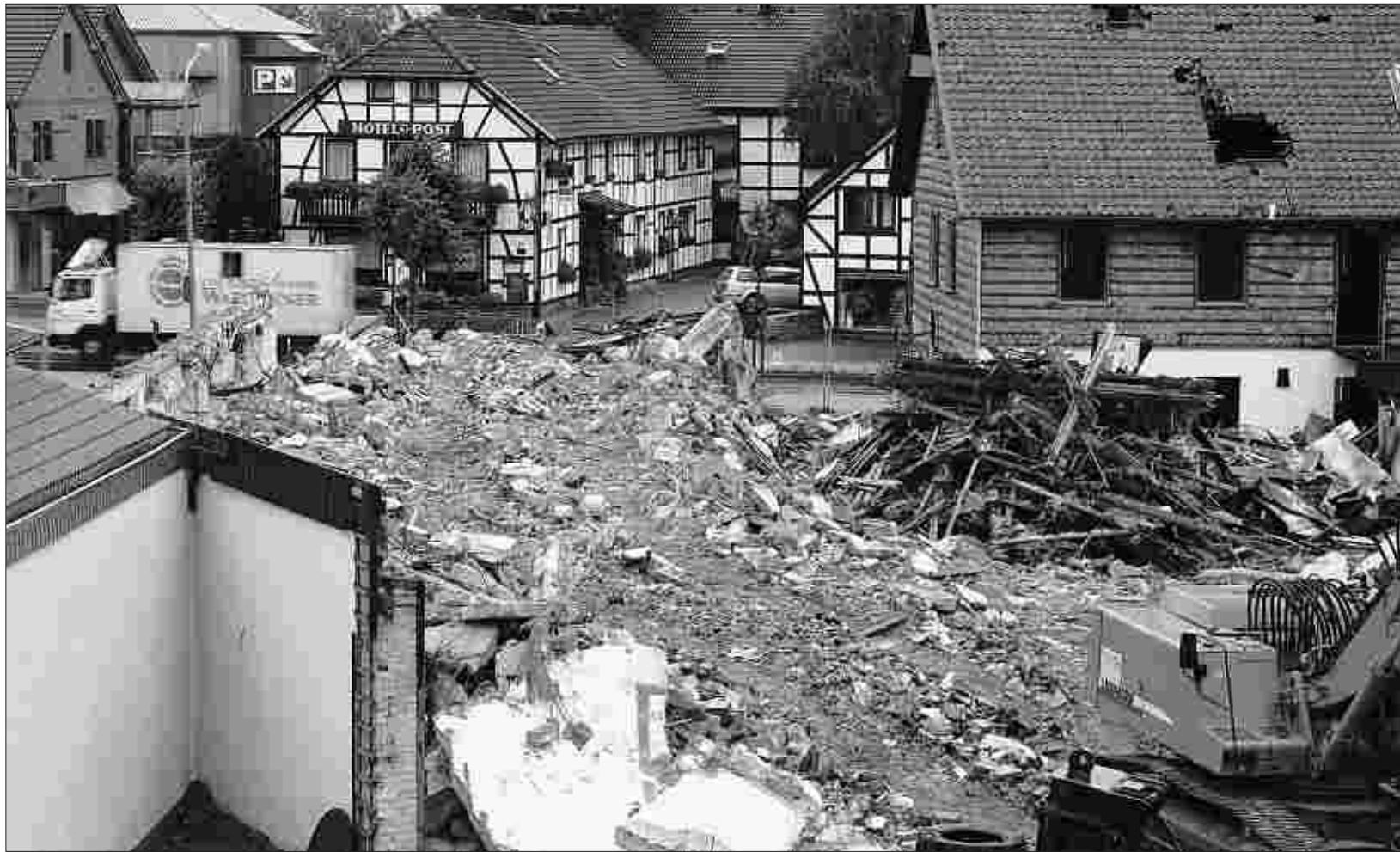
Am Boden zerstört ist das Haus Motter an der Hauptstraße in Simmerath. Auch ein Teil des Nebengebäudes (re.) fällt noch dem Bagger zum Opfer, um Platz für einen großzügigen Neubau zu schaffen. Foto: P. Stollenwerk
